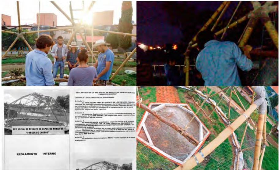
Jornadas posteriores al Summer Workshop. Diseño y construcción del exterior-interior del aviario. Agosto 2016 | Registro: Taller Transversal.
