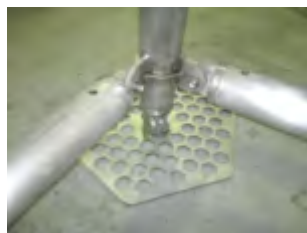
Figura 6.16: Vista posterior de las uniones. (Cortesía de [22])
