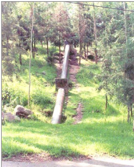
Fig. 13. Ramal descubierto de Red Sanitaria dentro del Parque Nacional “Fuentes Brotantes”. Fuente: Acervo propio
