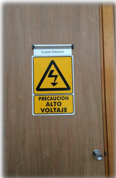
Imagen 13. Cuarto eléctrico del HPE- FESC (Garcés, 2016).
