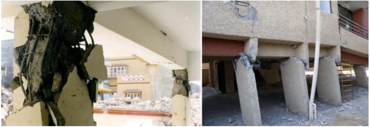
Fig. 6 Fallas en columnas de estructuras con piso suave (Aditi H. & Vipin V., 2015).
