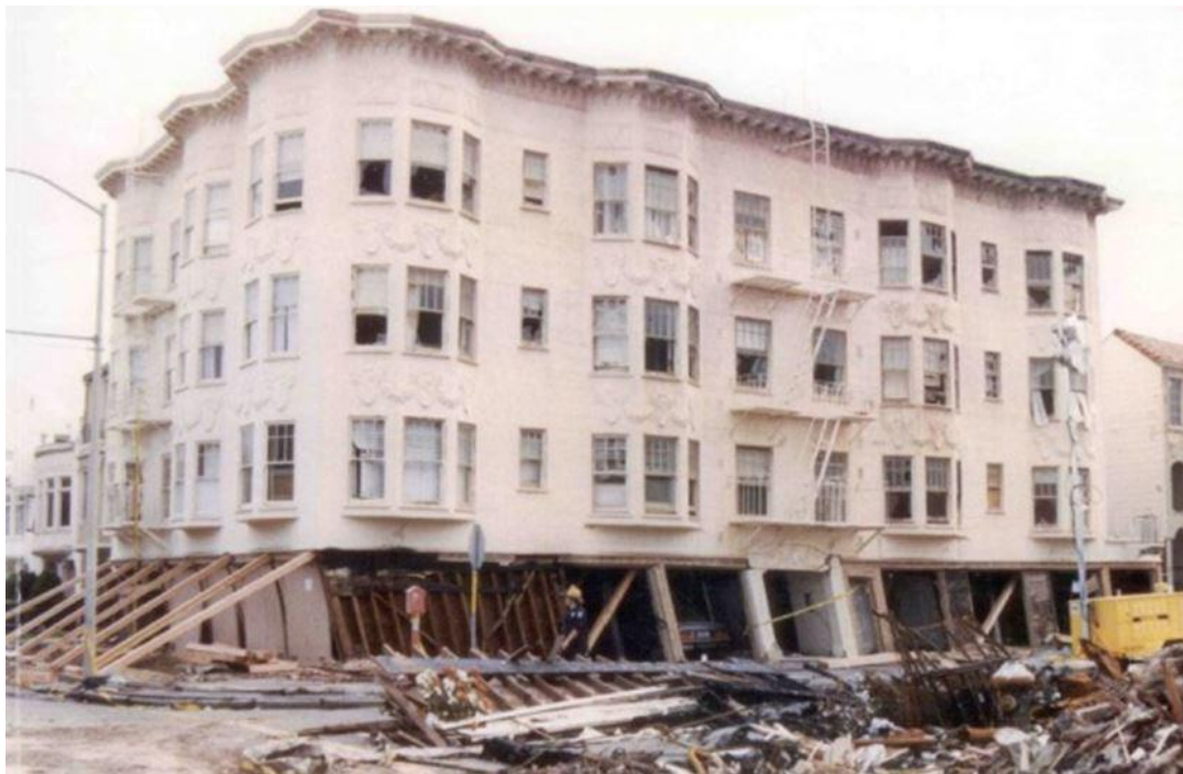
Fig. 5 Estructura con piso suave dañada durante sismo (Aditi H. & Vipin V., 2015).
