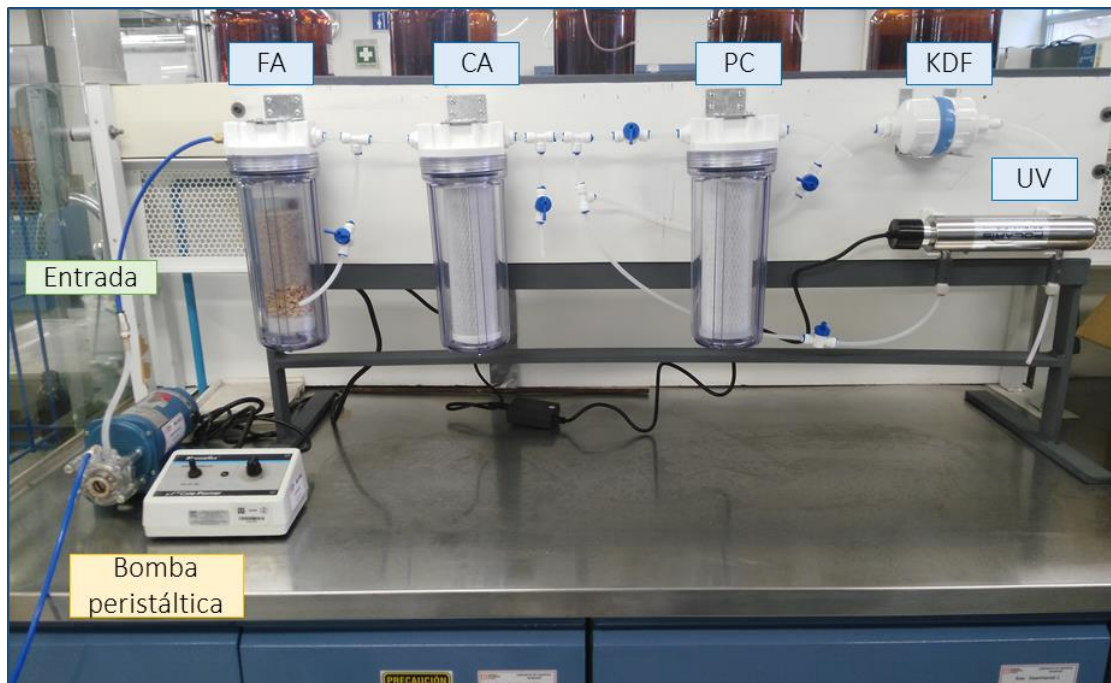
FIGURA 13 PLANTA PILOTO PARA LA POTABILIZACIÓN DEL AGUA DE LLUVIA CAPTADA EN LA AMC
