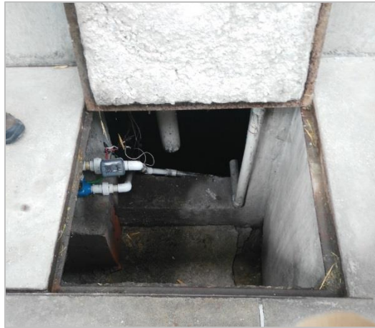
FIGURA 5 RESERVORIO UBICADO EN EL INTERIOR DEL AUDITORIO
