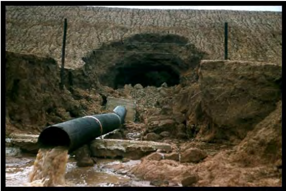
Figura 1.24 Falla por tubificación en una presa de Ohio. U.S. Department of Agriculture (2012).
