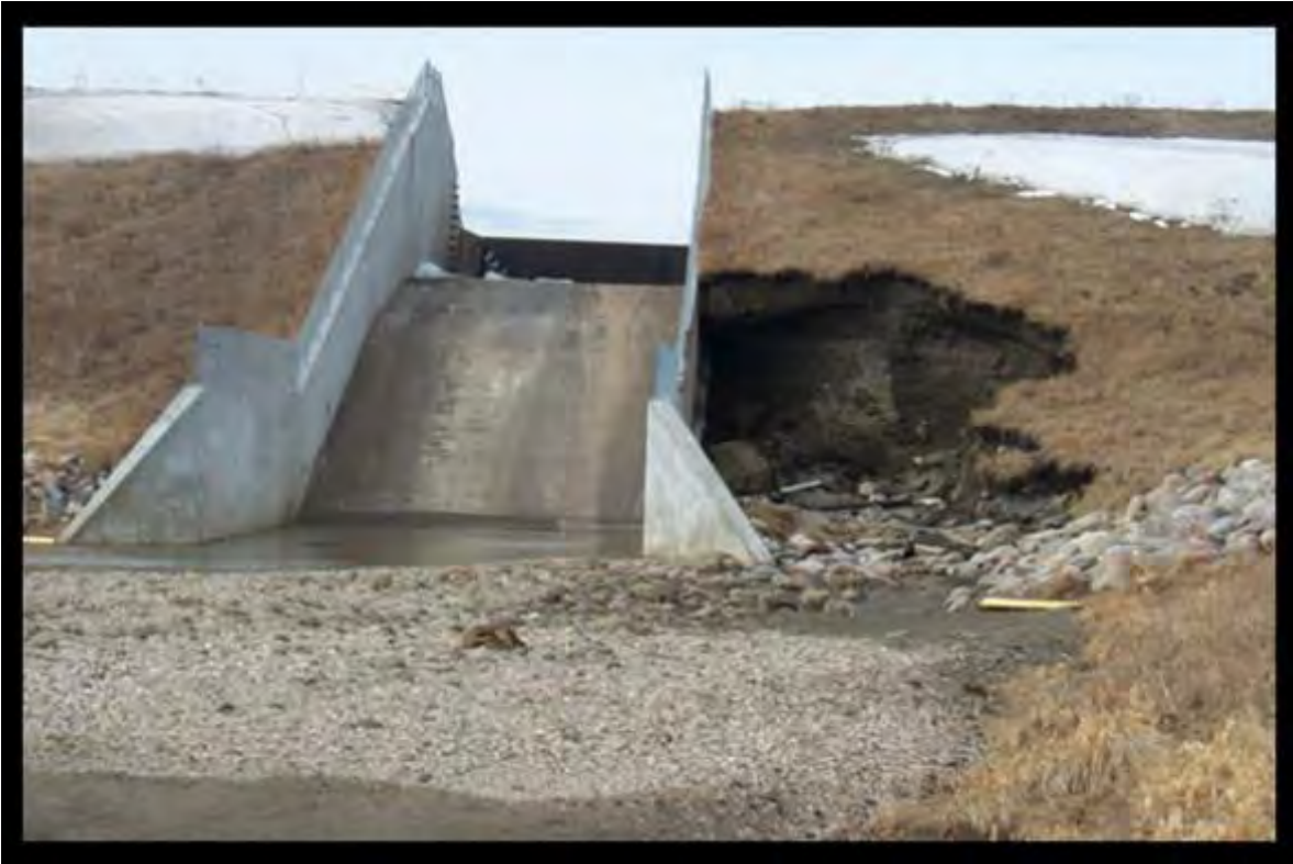
Figura 1.25 Falla por socavación al pie del vertedor. U.S. Department of Agriculture (2012).
