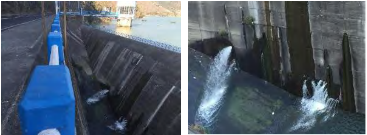
Figura 1.4 Filtración a través de las juntas de concreto en la Presa Valle de Bravo. Elaboración propia (2016).
