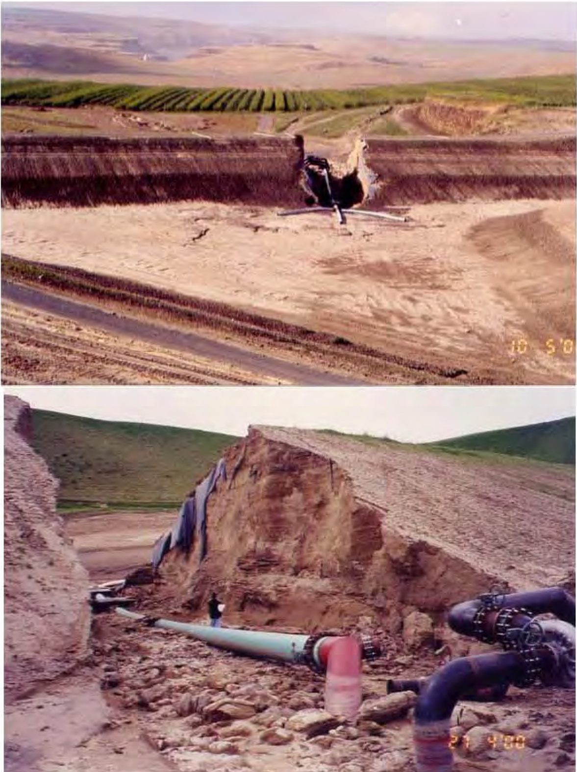
Figura 1.30 Falla de presa por tubificación en Walla Walla County. Washington State Department of Ecology (1993).
