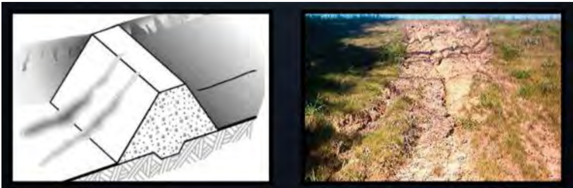
Figura 1.9 Falla por erosión del talud de la cortina aguas abajo. U.S. Department of Agriculture (2012).
