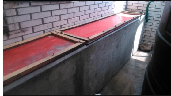
Tanques de sedimentación
