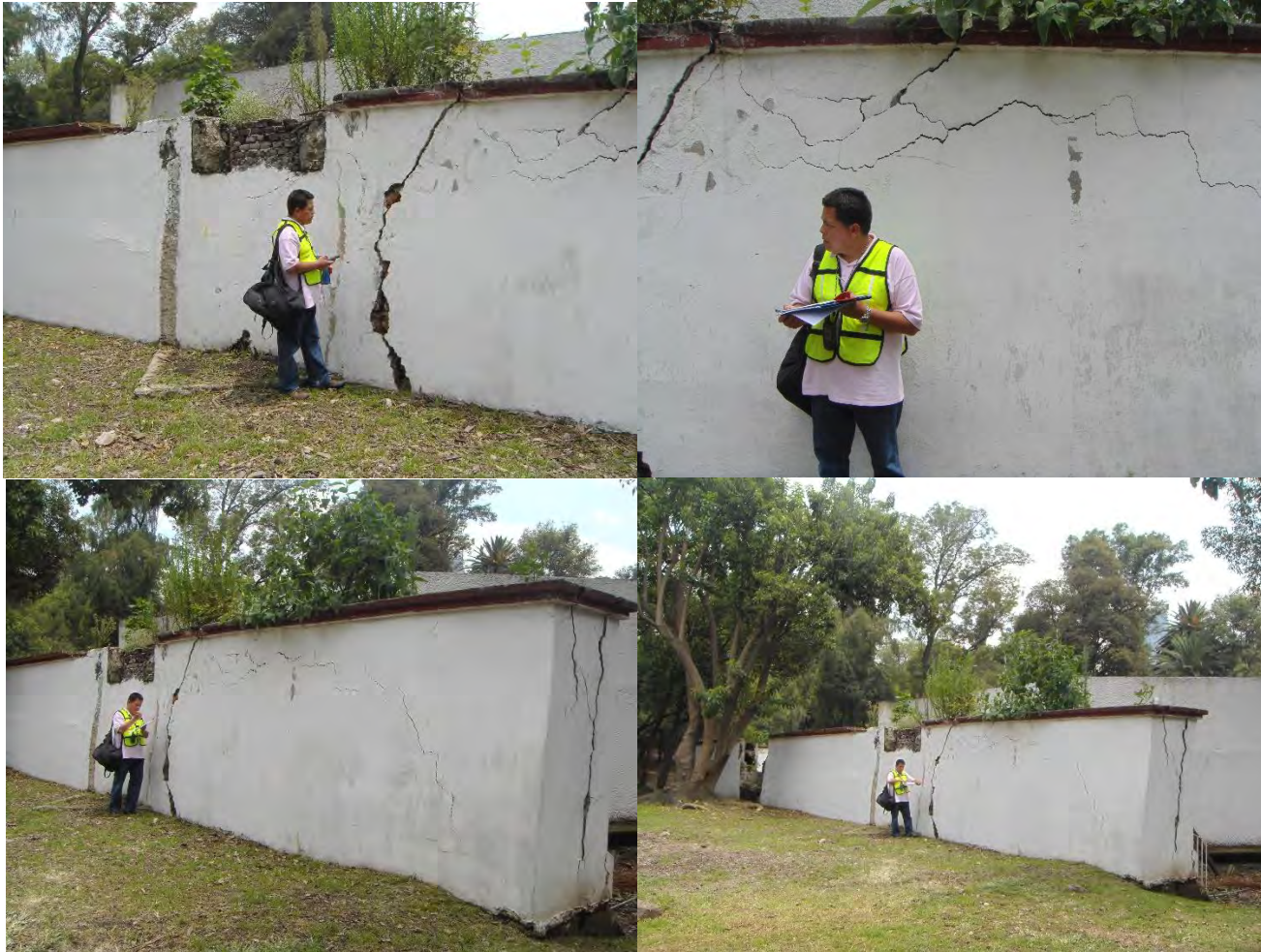
Descripción de las imágenes: Determinación de daños en la Quinta Colorada, Primera sección del Bosque de Chapultepec. Facultad de Ingeniería UNAM–CONACyT, septiembre 2014. Las imágenes presentan los daños visibles de los muros de la Quinta Colorada.
