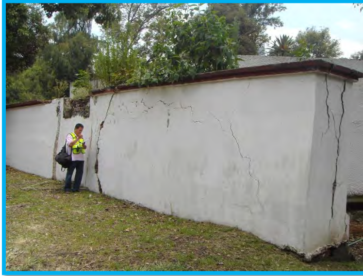
Fotografía 1. Muro dañado debido a asentamientos diferenciales del subsuelo (levantamiento de rasgos y anomalías superficiales. Facultad de Ingeniería UNAM-CONACYT, 2014).
