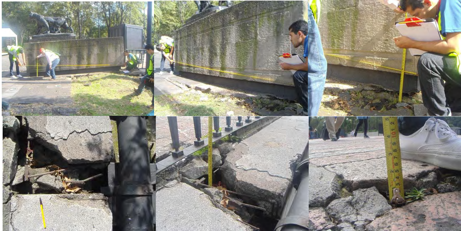
Descripción de imágenes: Determinación de daños a paso peatonal y estructura en el Puente de los leones, Primera sección del Bosque de Chapultepec. Facultad de Ingeniería UNAM–CONACyT, febrero 2014. Las imágenes presentan la toma de datos acerca de los daños que presenta el inicio del Puente de los Leones. Los daños se hacen más visibles en los laterales de los pedestales que sostienen las estatuas de leones.
