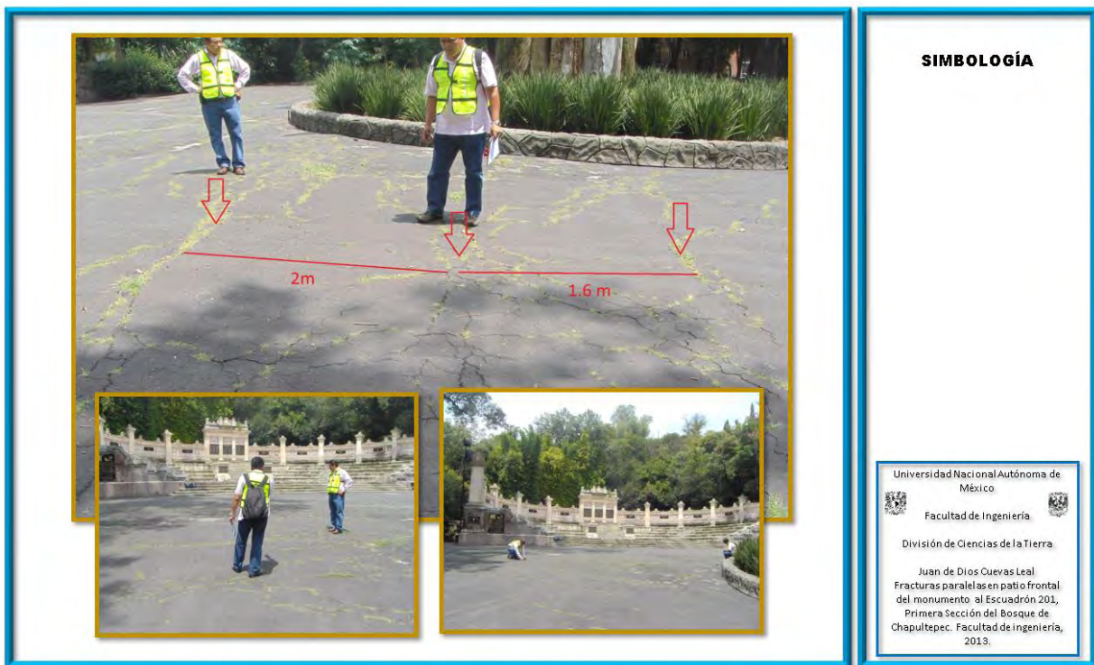
Fotografía 4. Fracturas paralelas en patio frontal del monumento al Escuadrón 201, Primera Sección del Bosque de Chapultepec (Facultad de Ingeniería UNAM, 2013).
