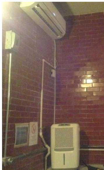
Figura 36: En la parte superior se muestra el aire acondicionado, en la parte inferior el deshumidificador
