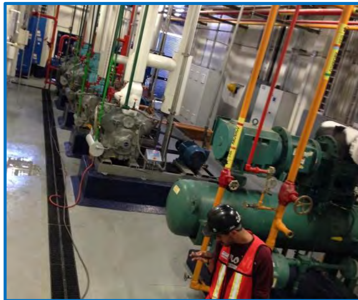
Figura 24. Distribución de equipos en cuarto de máquinas.
