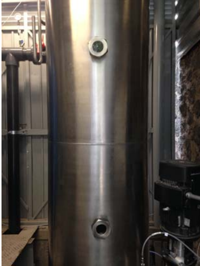
Figura 3.7. Mirillas del Tanque Presurizado
