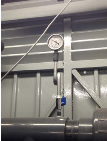
(A) Localizado detrás de los filtros
