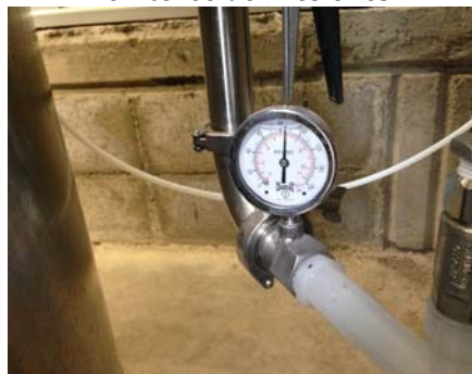
Localizado a un costado del tanque de contacto
