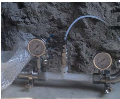
Localizado a un costado del tanque de contacto
