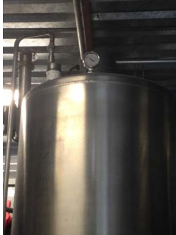
(B) Localizado arriba del tanque de contacto
