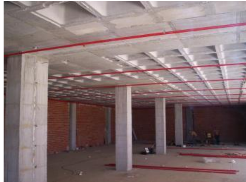
Instalación contra incendios en una nave comercial. Imagen: SISDECON MÁLAGA
