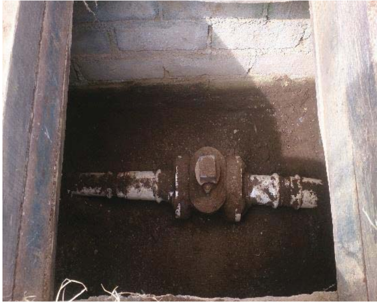
Fotografía 3.3 Válvula de paso.
