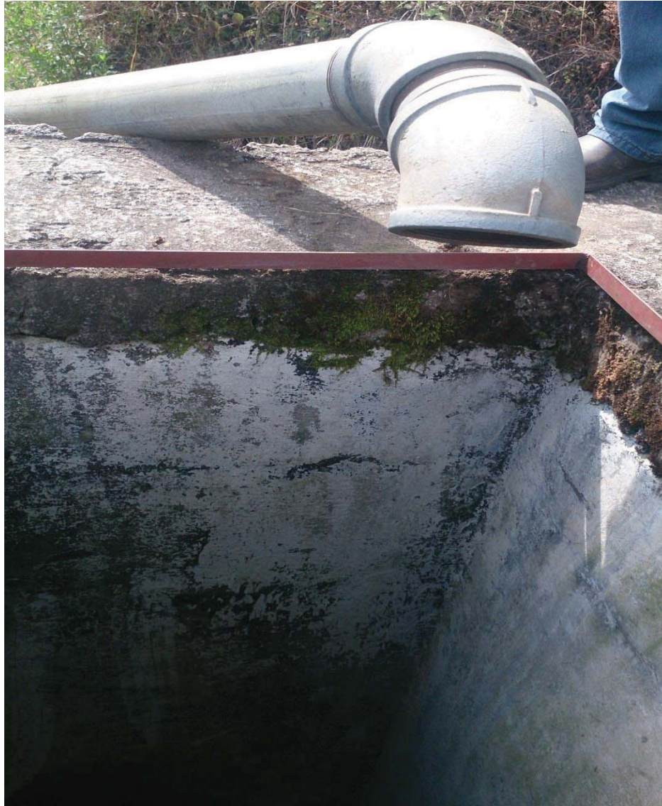
Fotografía 3.5 Conexión alimentadora del contenedor.
