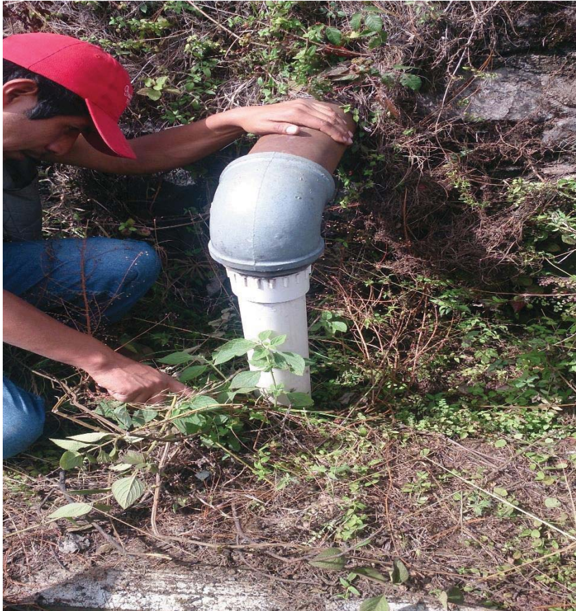
Fotografía 3.6 Conexión de distribución.
