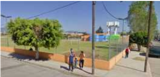
Foto 3: Vista de subestación.
