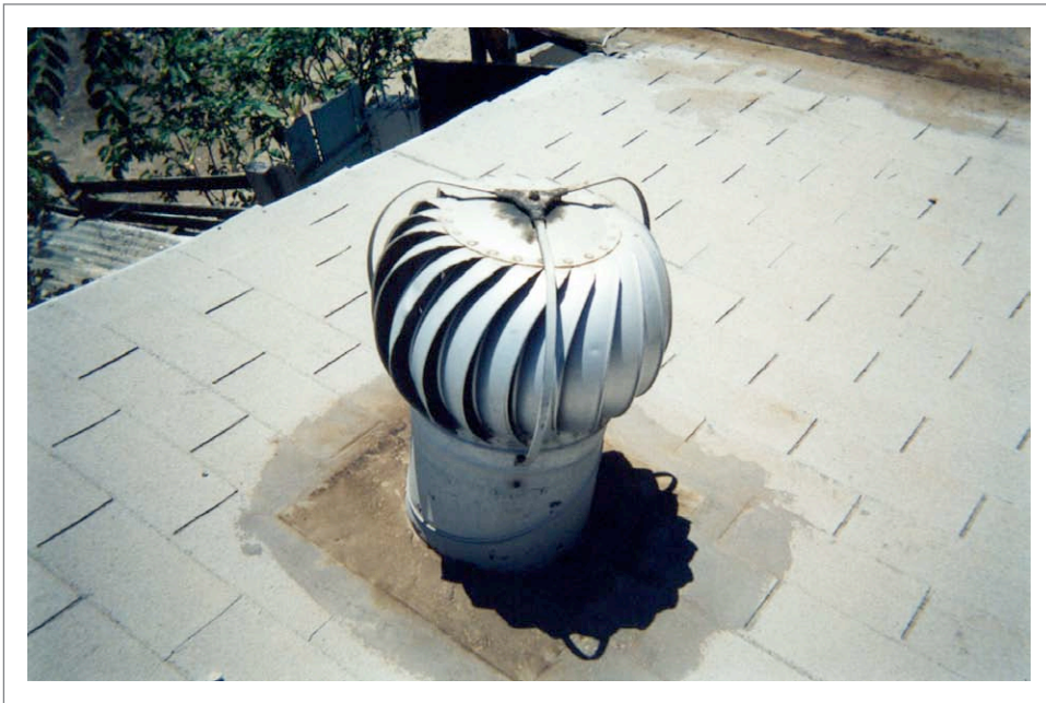
Lugar: Col. Obrera 3ª sección. Tijuana, B.C. Descripción: Ventilación en una vivienda ñuu savi Foto: Carolina Sánchez García Fecha: Junio - agosto 2002
