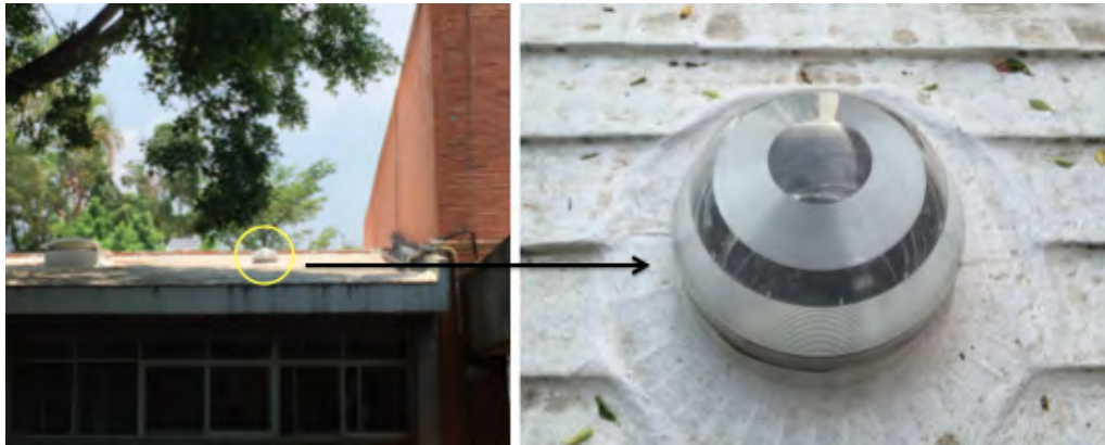
Figura 4.4: Tubo solar (TS) instalado en la cubierta de la oficina de la dirección del IER-UNAM.
