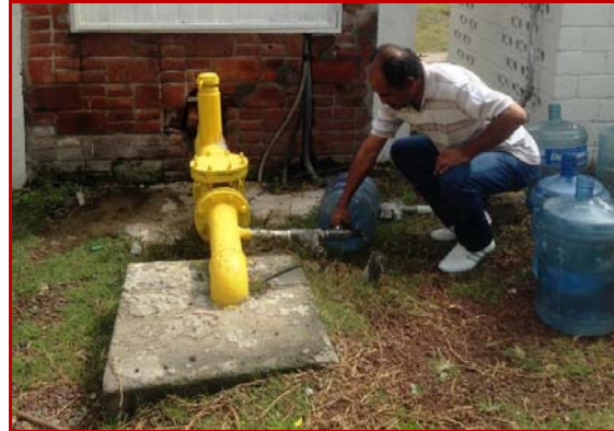
Figura 14. Pozo para agua potable comunidad de Teocalco de Tula.
