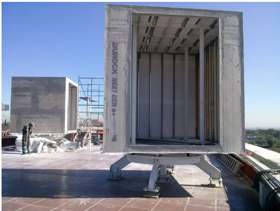
Imagen 17. Fabricación de la envolvente externa. (USG Durock) Vano de la Cara de Experimentación.
