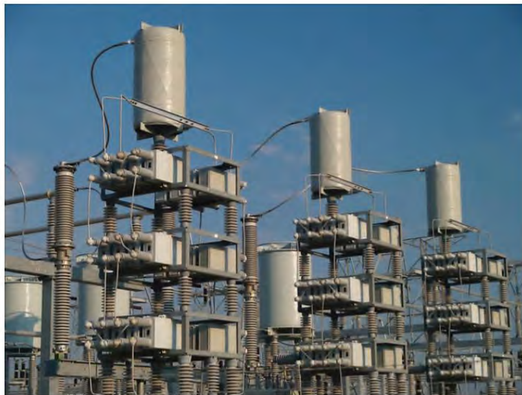
Figura 1.3 Banco de capacitores usado para la corrección del factor de potencia.
