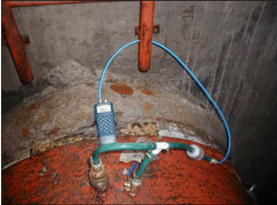
Figura II.21. Medición de presión en tuberías. Fuente: Martínez, 2003.
