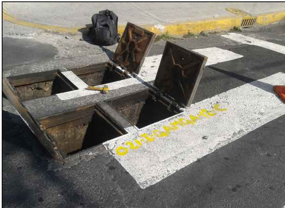
Figura III.17. Caja de válvulas con varias tapas. Fuente: PSC, 2013.
