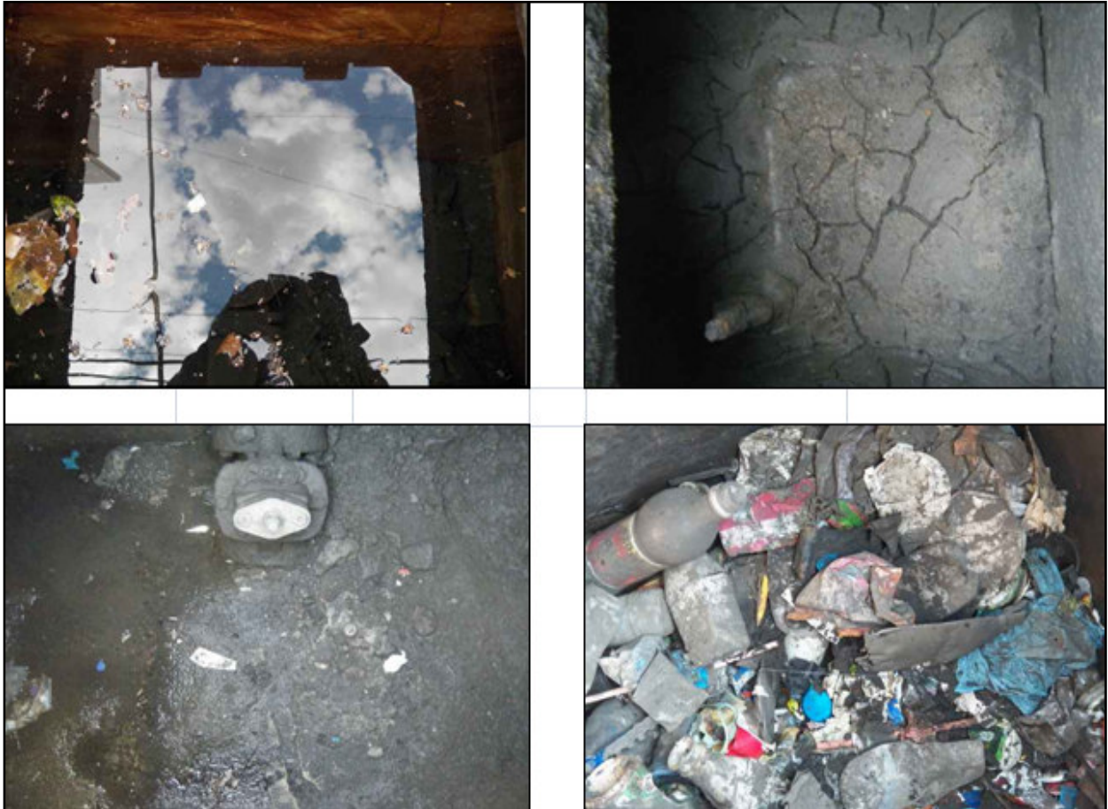
Figura III.33. Caja de válvulas que requiere de un proceso de achique o desazolve. Fuente: PSC, 2013.
