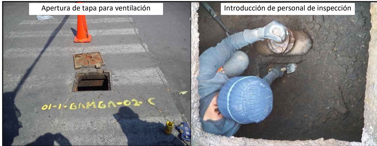
Figura III.16. Cajas con dificultad para ser inspeccionadas desde fuera. Fuente: PSC, 2013.
