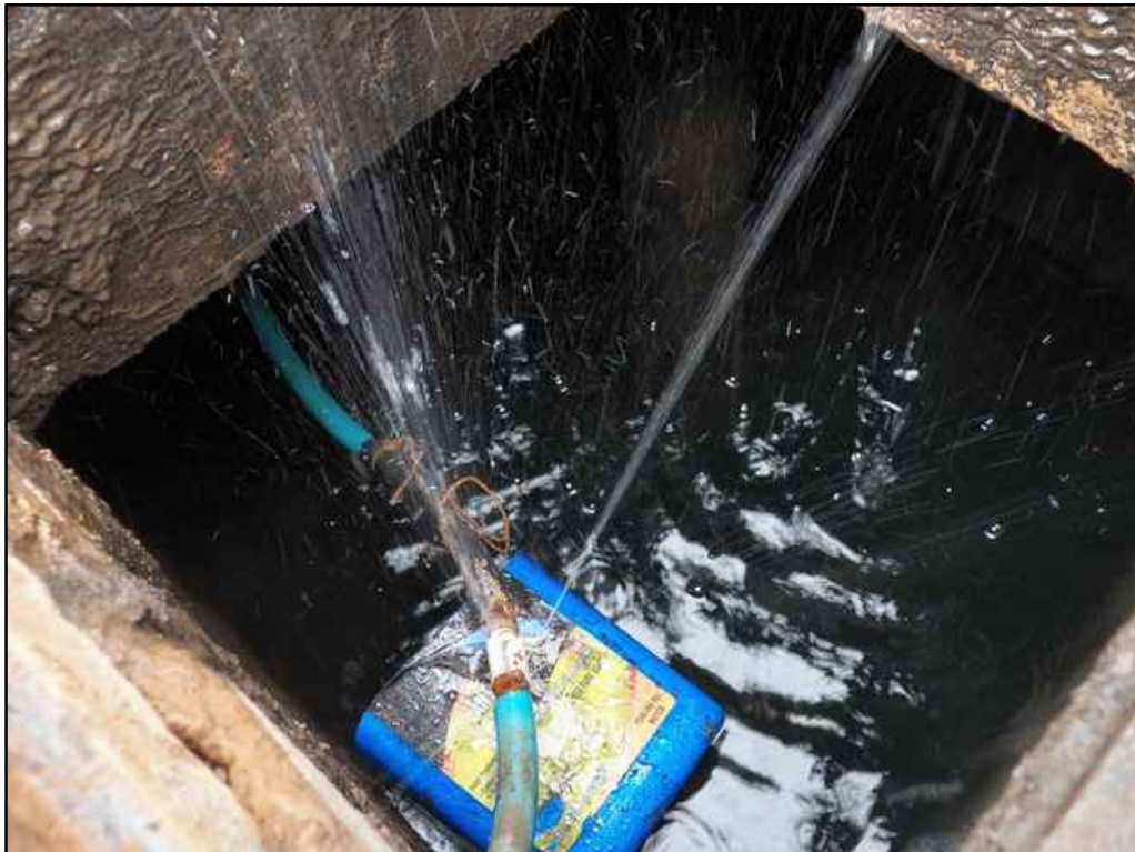
Figura II.20. Fuga ocasionada por una toma clandestina. Fuente: PSC, 2013.
