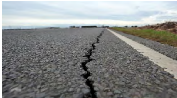
Figura 2.8 Deformación por fractura térmica del asfalto.[13]
