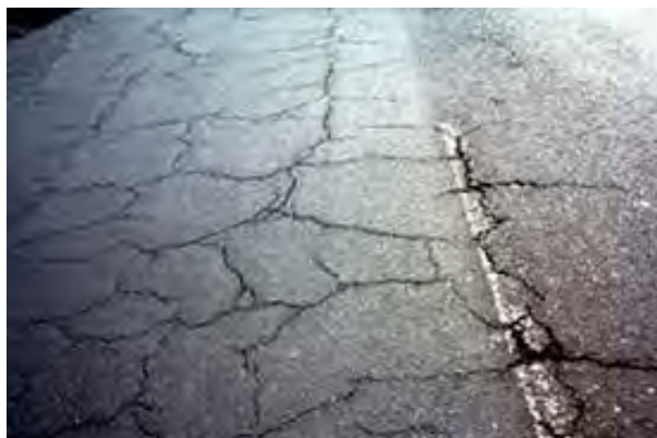
Figura 2.9 Deformación de fractura por fatiga del asfalto.[14]
