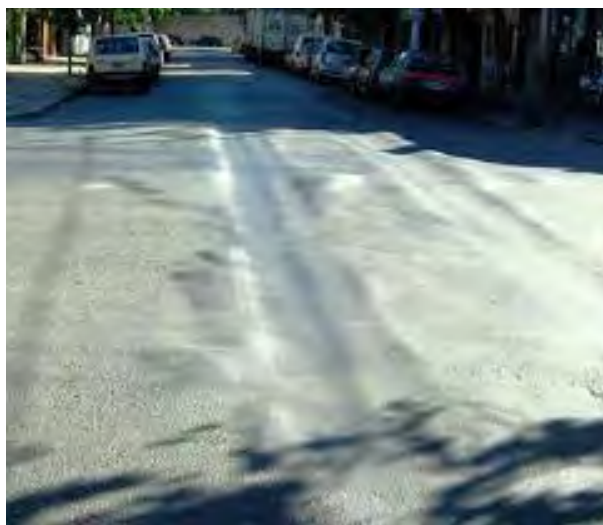
Figura 2.7 Deformación permanente del asfalto.[12]
