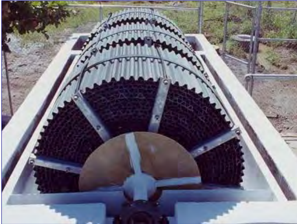
Figura No. 10. Disco biológico instalado. Fuente del autor.
