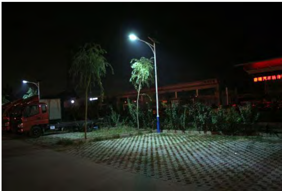
FIG 104: Lampara led montada en un poste a 5 metros de altura
