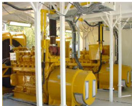
Figura 1.24 Generadores de energía.
