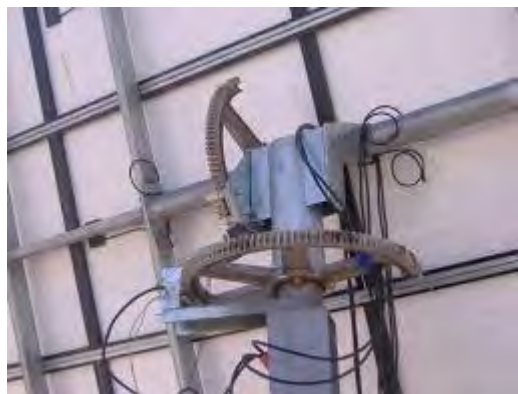
Imagen II.11: Mecanismo de seguimiento solar (acimutal)
