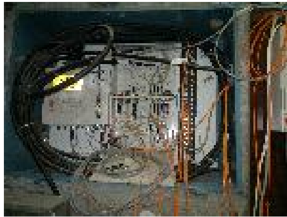
Figura 2.3: Distribuidor de Fibra óptica del Edificio “M”.
