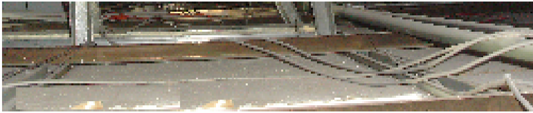
Figura 2.13: Canalizaciones por el techo falso
