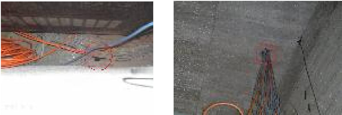
Figura 2.10: Cableado Vertical de la DICyG.
