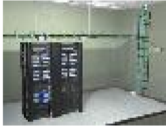
Figura 1.61: Sala de Equipos
