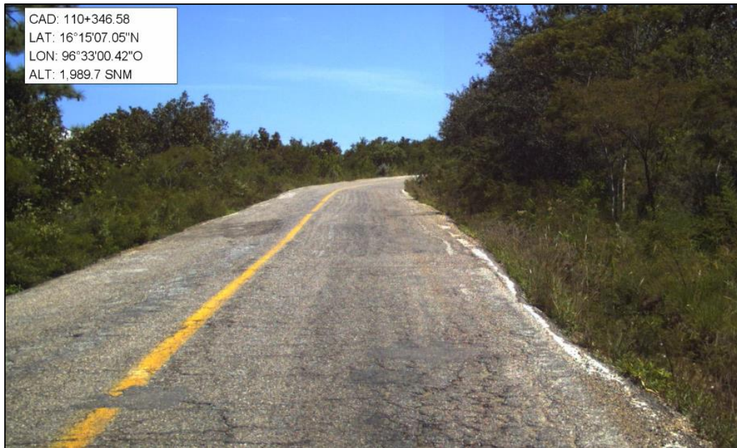
Figura 12. Daños en la carretera Oaxaca-Puerto Ángel, kilómetro 110.3.
