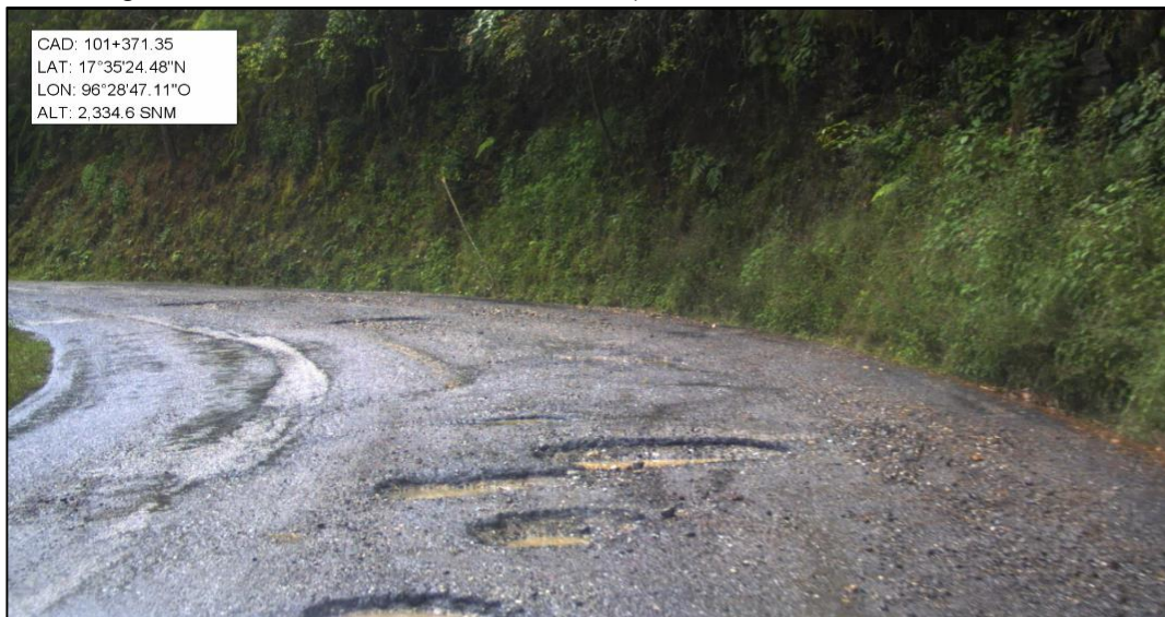
Figura 10. Daños en la carretera Tuxtepec-Oaxaca, kilómetro 101.3.
