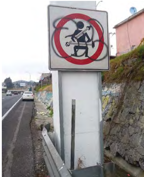
Figura 4.9 | Uso obligatorio del cinturón de seguridad y ausencia de kilometraje, con la presencia urbana es posible que se dé el robo de los señalamientos y el vandalismo en la zona.
