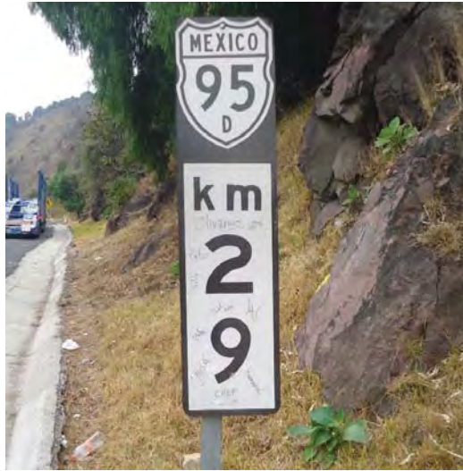
Figura 4.5 | Existencia de vandalismo con grafiti en la señal del Km 29+000, además se observa la ausencia de un tornillo en la parte de abajo.
