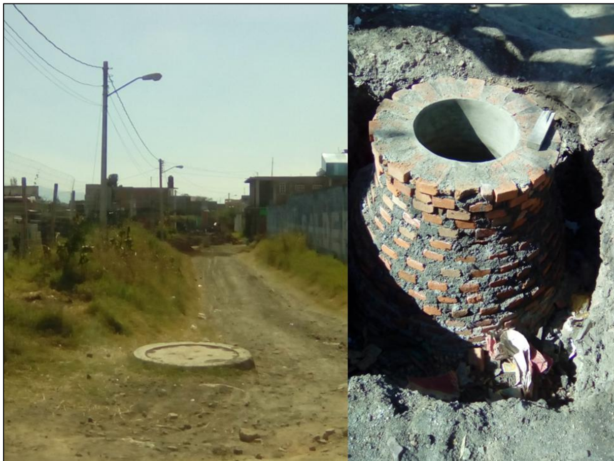
Figura 4.26 Coladera de drenaje en GS (izquierda) y pozo de agua (derecha). Fuente: Fotografías propias
