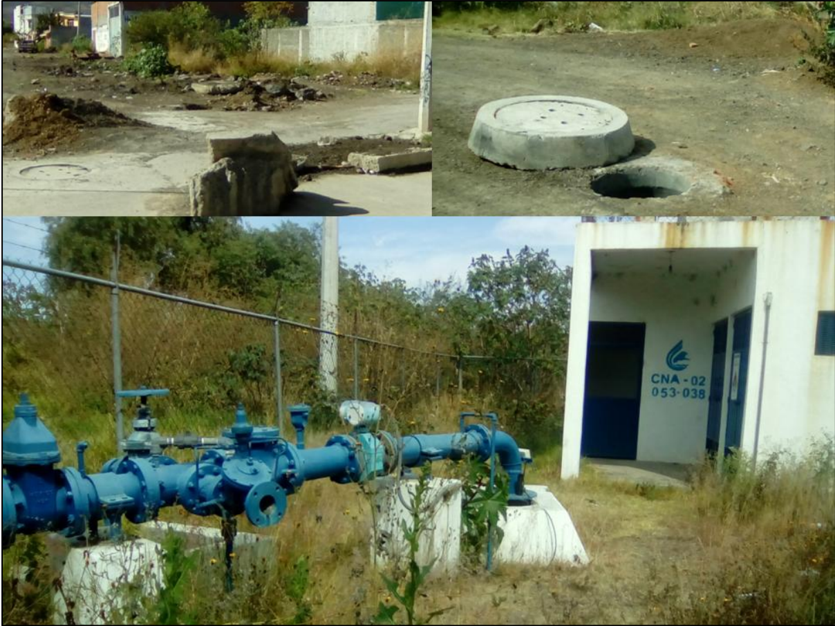
Figura 4.27 Coladeras y mejoramientos en el sistema de drenaje en AGS (arriba). Bomba de agua de la CNA en AGS. Fuente: Fotografías propias
