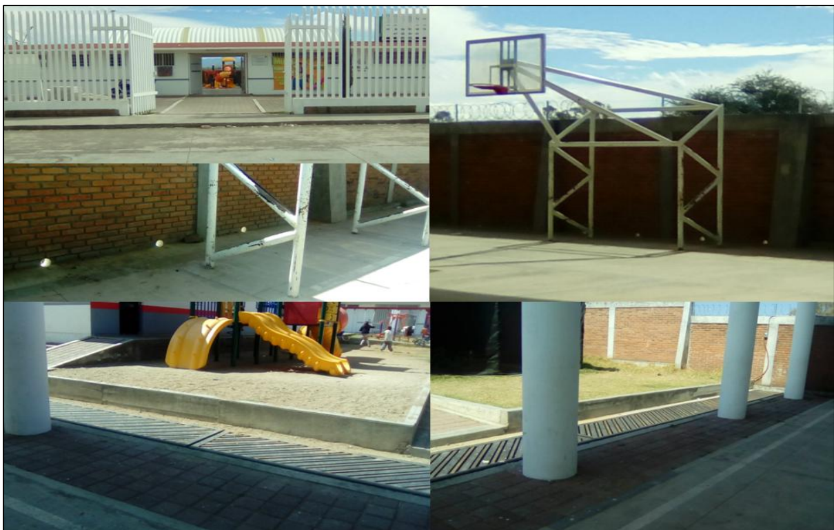
Figura 4.16 Coladeras y agujeros de desagüe auto-construidos dentro del Centro Comunitario de Gertrudis Sánchez, Etapa IV. Fuente: Fotografías propias
