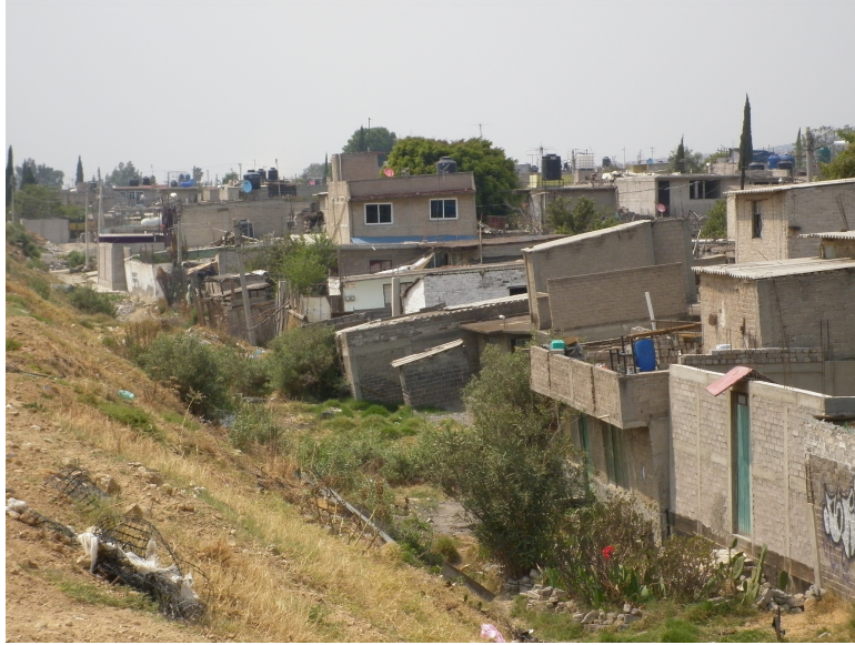
Figura 8. La imagen muestra la inclinación de las viviendas aledañas al canal de la Compañía (a la izquierda) debido a la deformación del suelo. El debilitamiento de las estructuras urbanas es evidente, por lo que la explotación del acuífero debería disminuirse sustancialmente.
