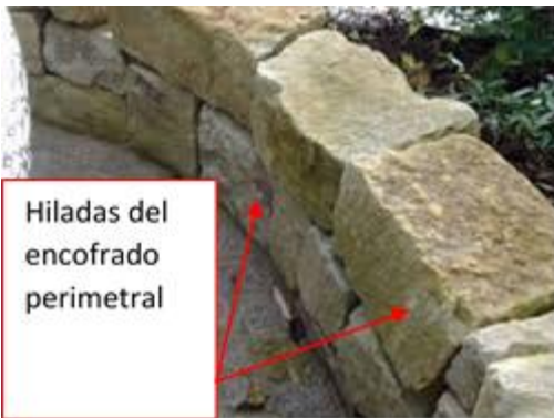
Imagen 177 Cortés Juan. Propuesta del encofrado perimetral del sistema de envolvente de contención de empuje horizontal. Croquis y modelos 3D. 2015. Acervo J. Cortés.
