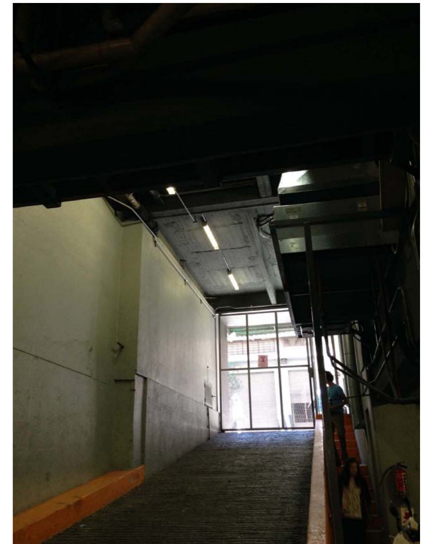
02. ESTADO ACTUAL DE LA RAMPA DE ESTACIONAMIENTO
