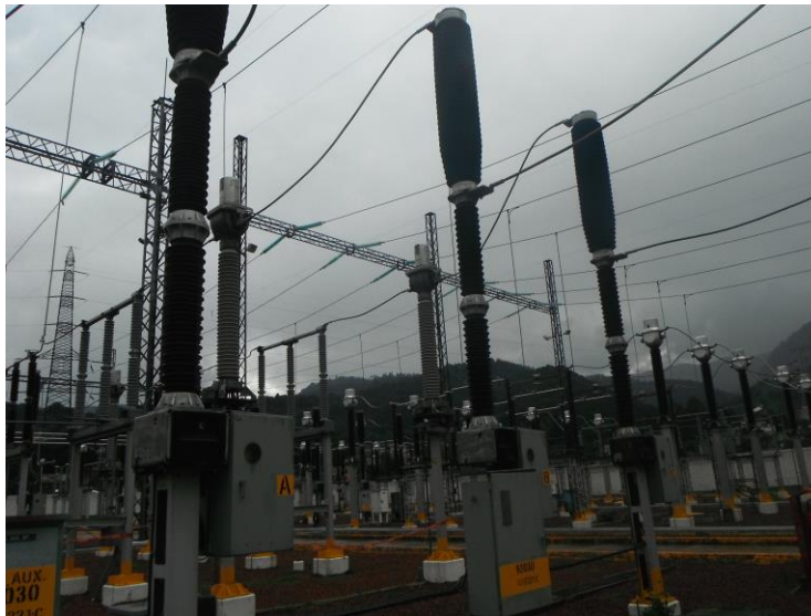
Figura 2.6 Interruptor de 230kV marca SIEMENS modelo 3APG
