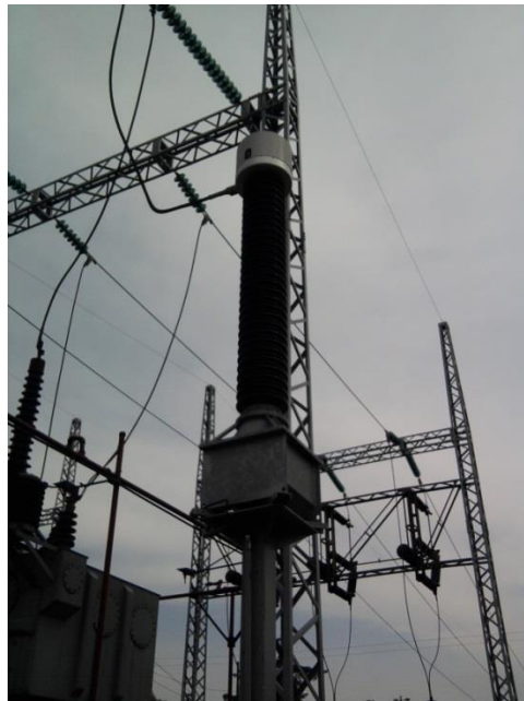
Figura 2.4 Transformador de potencial de 230kV
