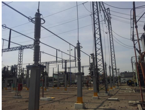
Figura 3.11 Apartarrayos en un transformador de 230/23kV
