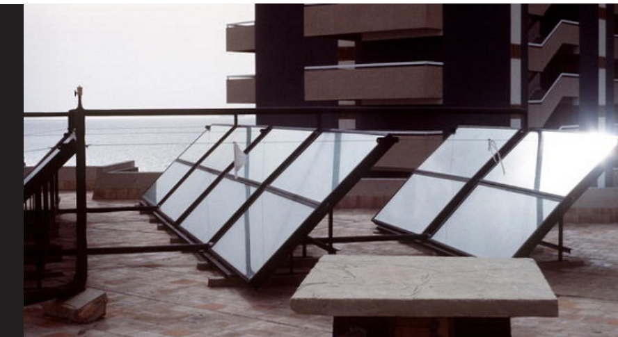
Fig. 58 Los principios en instalaciones FV se encontraban en las azoteas. Fuente: https://is.gd/uRqZie
