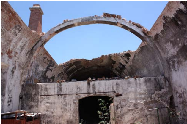
Imagen 11. Bóveda desplomada de la nave de destilación, Fábrica de mezcal de Bocas (2013).
