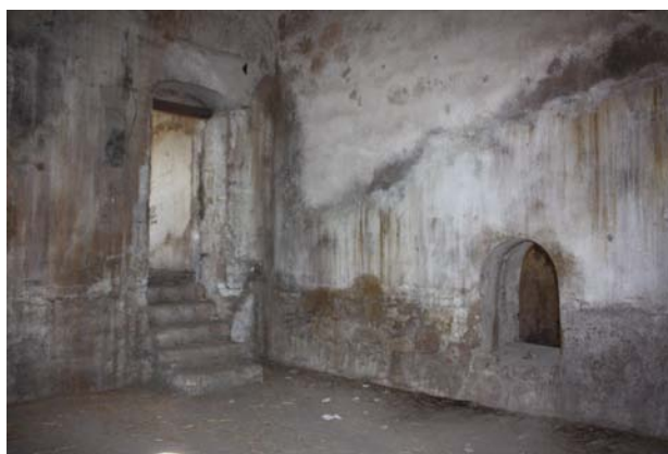
Imagen 15. Perdida de aplanado, aparición de hongos y eflorescencias por acumulación de humedad. Fábrica de mezcal de Jaral de Berrio (2013)
