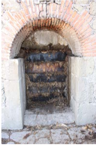
Imagen 10. Detalle de las entradas de los hornos, hechas de ladrillo y piedra, selladas con tabloncillos de madera cuando el horno está lleno (2013).
