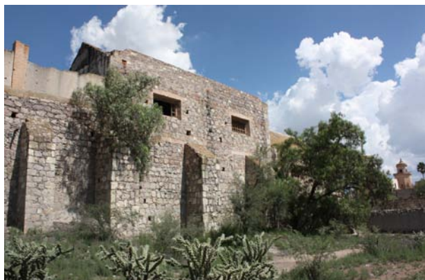
Imagen 14. Vegetación parasita en contrafuertes de los muros de fachada de mampostería. Fábrica de mezcal de Jaral de Berrio (2013)
