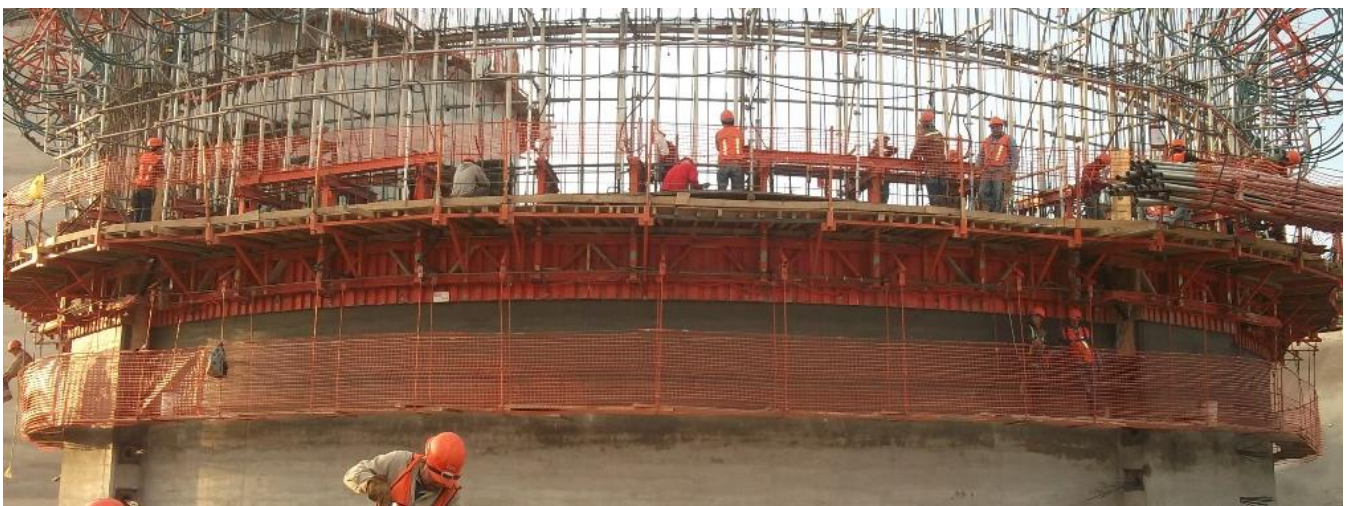
ILUSTRACIÓN 43 DESLIZADO DE MURO CARA EXTERIOR
