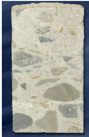
Figura 2 Segregaciones del concreto.
