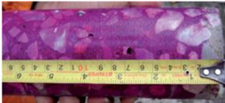
Figura 14 Efecto de una muestra de concreto con aplicación de fenolftaleína, donde se aprecia las variaciones de color, la parte que toma el color fusha no está carbonatada, la zona que no cambia de color ha sido afectada por carbonatación
