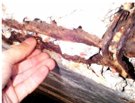
Figura 11 Corrosión del acero de refuerzo por ataque de cloruros
