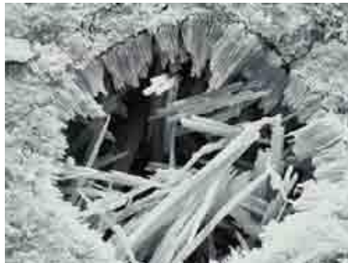
Figura 10 Depósitos de etringita secundaria formándose en un vacío
