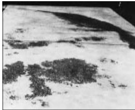
Figura 3 Mancha en una superficie de concreto
