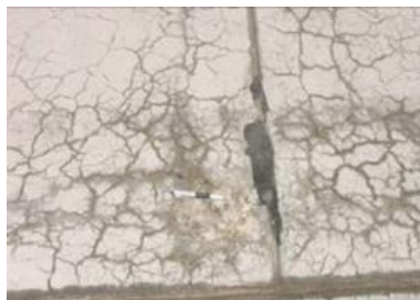
Figura 4: Fisuras en forma de mapeo formadas por reacción álcali-agregado
