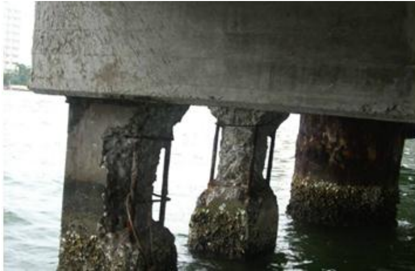
Figura 9: Deterioro del concreto expuesto a agua de mar
