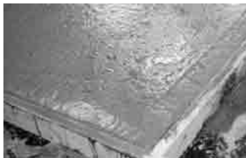
Figura 1 Sangrado de concreto en una losa
