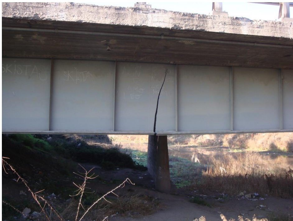
Figura 1.1 Ejemplo de fractura en un elemento debido a fatiga [web]
