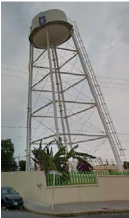
IMÁGEN: Tanque elevado, Odapas, Av. Felipe Villanueva FUENTE: Elaboración Propia. José Manuel Pérez Cisneros
