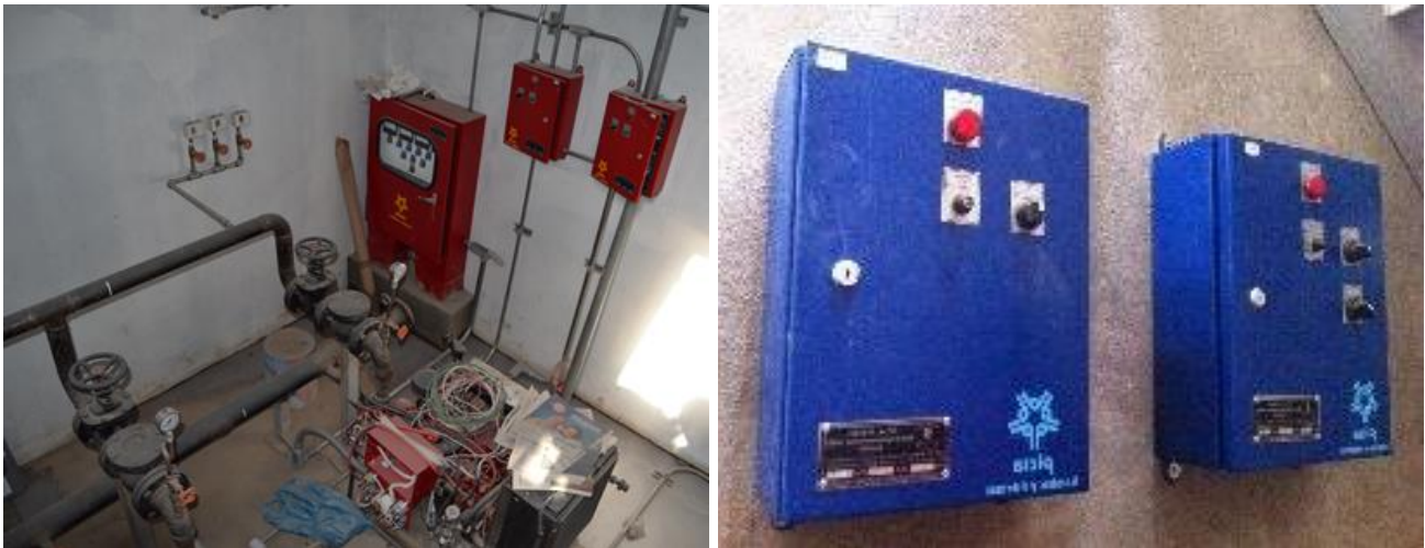
Figura III.33 Conexión y puesta en marcha de tableros de sistema contra incendios e hidroneumático.
