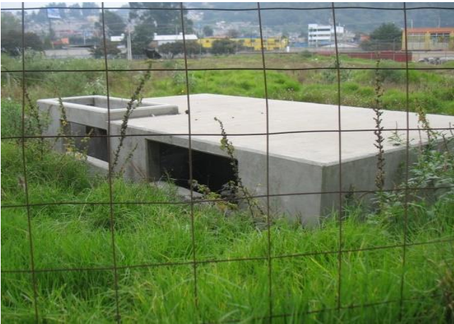
c) Cuarto de máquinas
