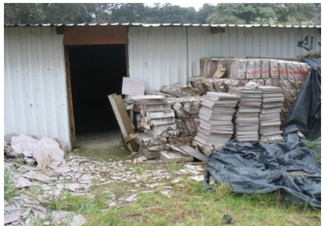
f) Piso de loseta cerámico abandonado en el sitio de los trabajos.
