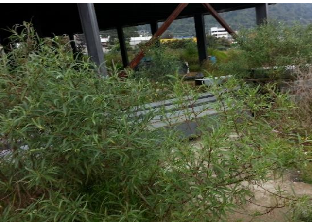
e) Estructura metálica abandonada en el sitio de los trabajos
