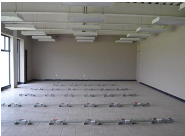
Figura III.72 Instalaciones eléctricas en laboratorio de cómputo
