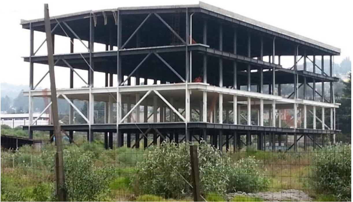
Figura III. 43 Estado de la obra abandonada desde 2013
