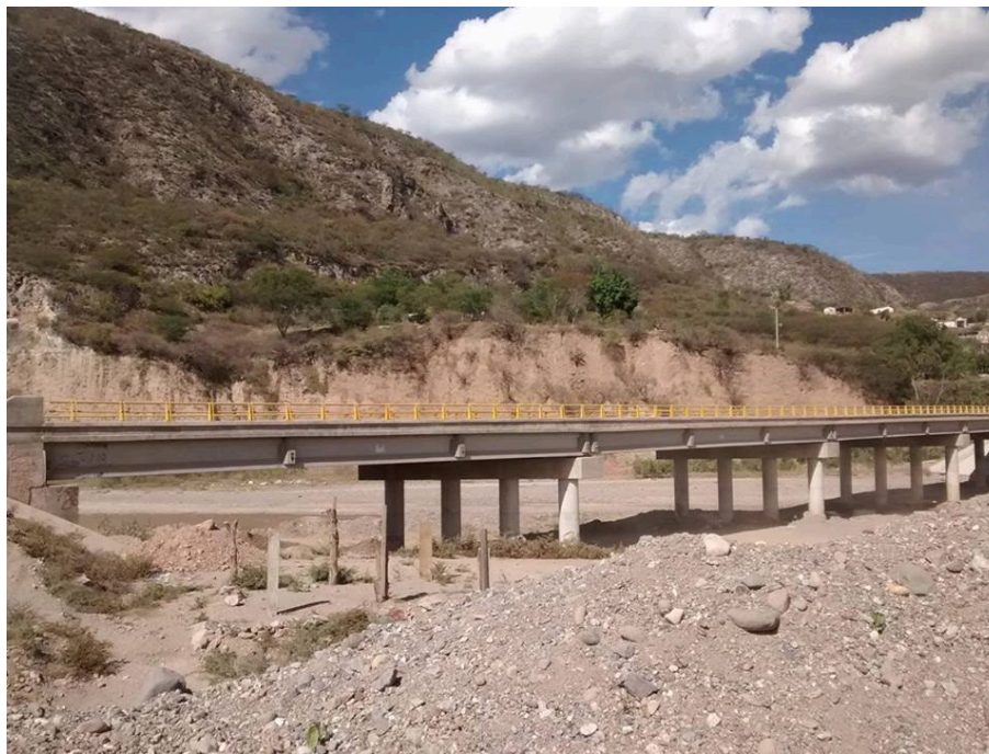
Figura 17. Puente nuevo que conecta la colonia Sinaí con el resto de la ciudad de Tlapa
