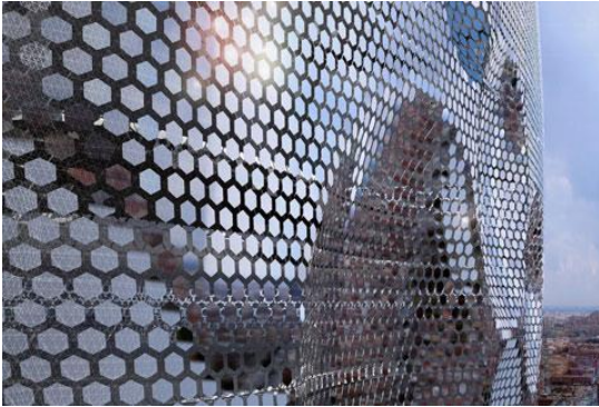
Fachadas que hacen uso de cristales fotovoltaicos
