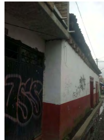
Fotografía tomada de norte a sur en Av. Independencia a la altura del cruce con Lázaro Cárdenas. Nótese como el espacio para de la baqueta es menor a 40 cm, lo cual genera que los peatones transiten por la avenida.
