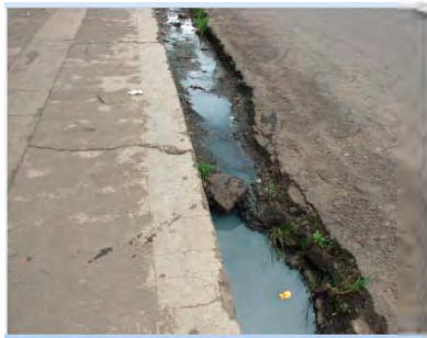
Fotografía que muestra el escurrimiento que se genera en la vialidad conocida como Zaragoza
