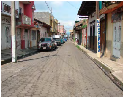
Fotografía del estado de las vialidades con pavimento de adoquín.
