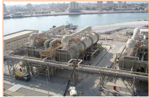
Figura 7. Planta desaladora MED-TVC, Al-Khaimah (TEDAGUA, 2015).
