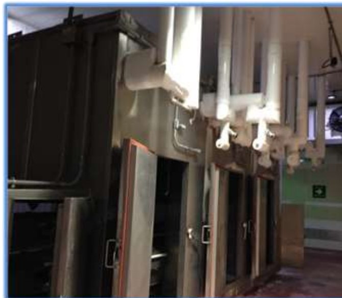
Figura 26. Fotografía en campo del túnel de congelación de tres módulos ROSS.
