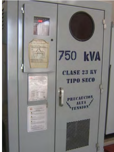
FIGURA 6.1 PUNTO DE INSTALACIÓN DEL ANALIZADOR DE REDES (SUBESTACIÓN) EN EL C. C. I. Q. S.
