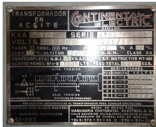
FIGURA 6.2 PLACA DE DATOS DE TRANSFORMADOR DEL EDIFICIO D DE LA FACULTAD DE QUÍMICA.
