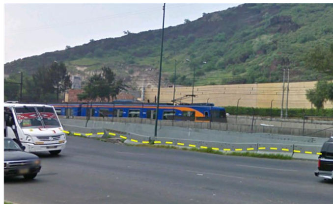
Figura 2.13 Efectos del hundimiento en la Calzada Ignacio Zaragoza.
