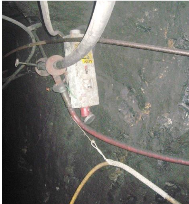
Figura 4.10 Peligro y riesgo; ploga y cable eléctrico junto a tubería de agua, en la mina Tecolotes
