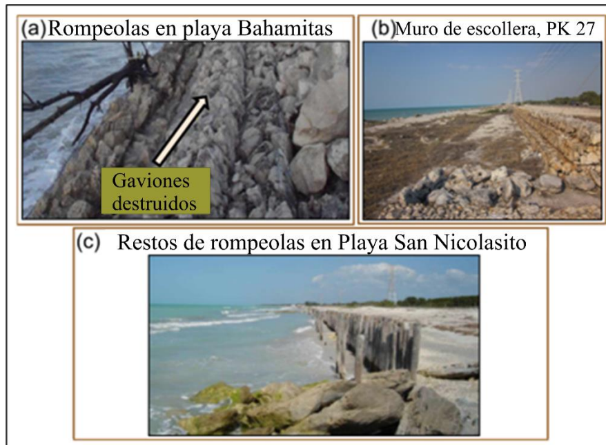
Figura X.34. Estructura de escollera en Isla del Carmen: (a) Rompeolas en playa Bahamitas (modificado de Bolongaro A. et al., 2007); (b) Muro de escollera en PK 27, para proteger la carretera que cruza la isla; (c) Restos de rompeolas en playa San Nicolasito (modificado de Bolongaro et al., 2007).
